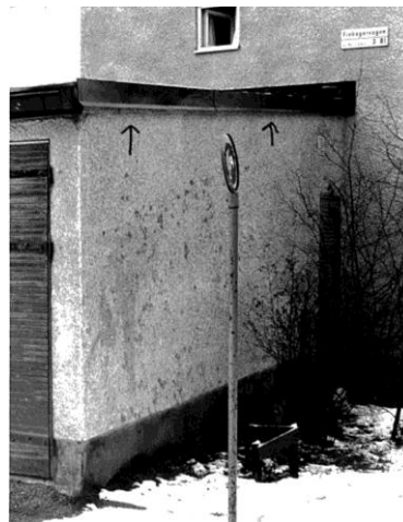
1964 (Brf arkiv, pilarna kommer från en skadeinventering)
