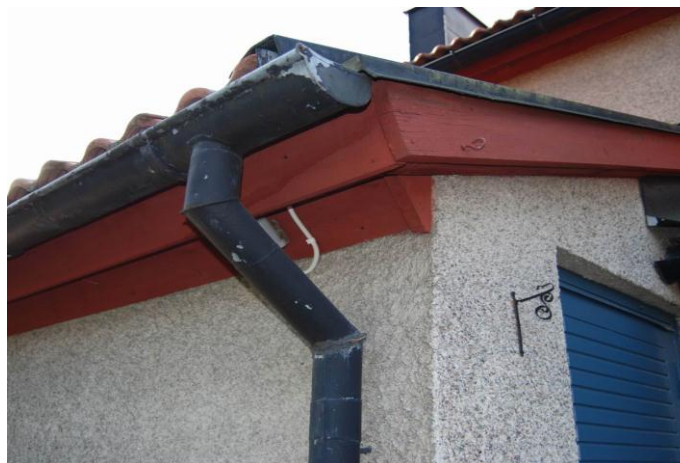
Stuprör med skarpa vinklar. 20120906sb-152
